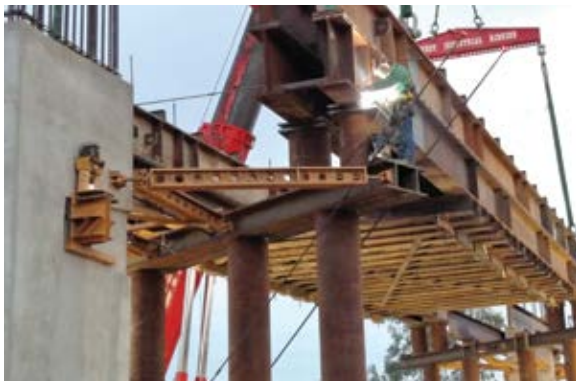
Colocación de la viga para la primera pila tipo caballete de la carretera I-10 Pápago
