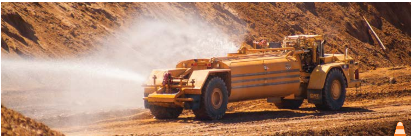
Movimiento de tierra para construir el camino y los terraplenes (Foto de ADOT)
